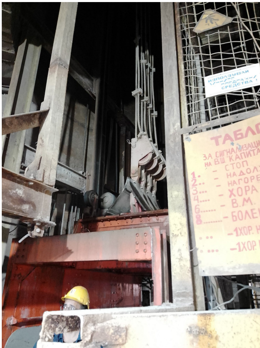
Фигура 3.4. Твърдо окачващо устройство за многовъжена подъемна уредба работеща на шахта „Крушев дол“ – в „Горубсо“-гр. Мадан
