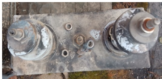
Фиг. 2. Кондензаторен елемент след късо съединение в съседен елемент
