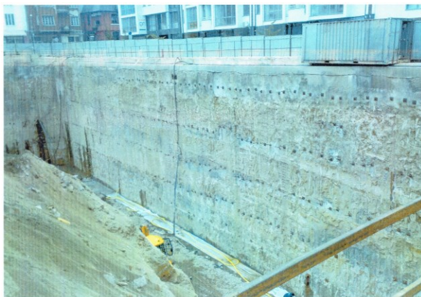
Фиг. 1. Снимка на откопания изкоп за сграда на ул. „Позитано“ в гр. София, укрепен с анкерирани шлицови стени
