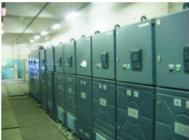
Фиг. 3. Външен вид на КРУ след реконструкция
