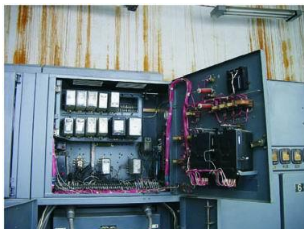
Фиг. 2. Релеен отсек на КРУ преди реконструкция
