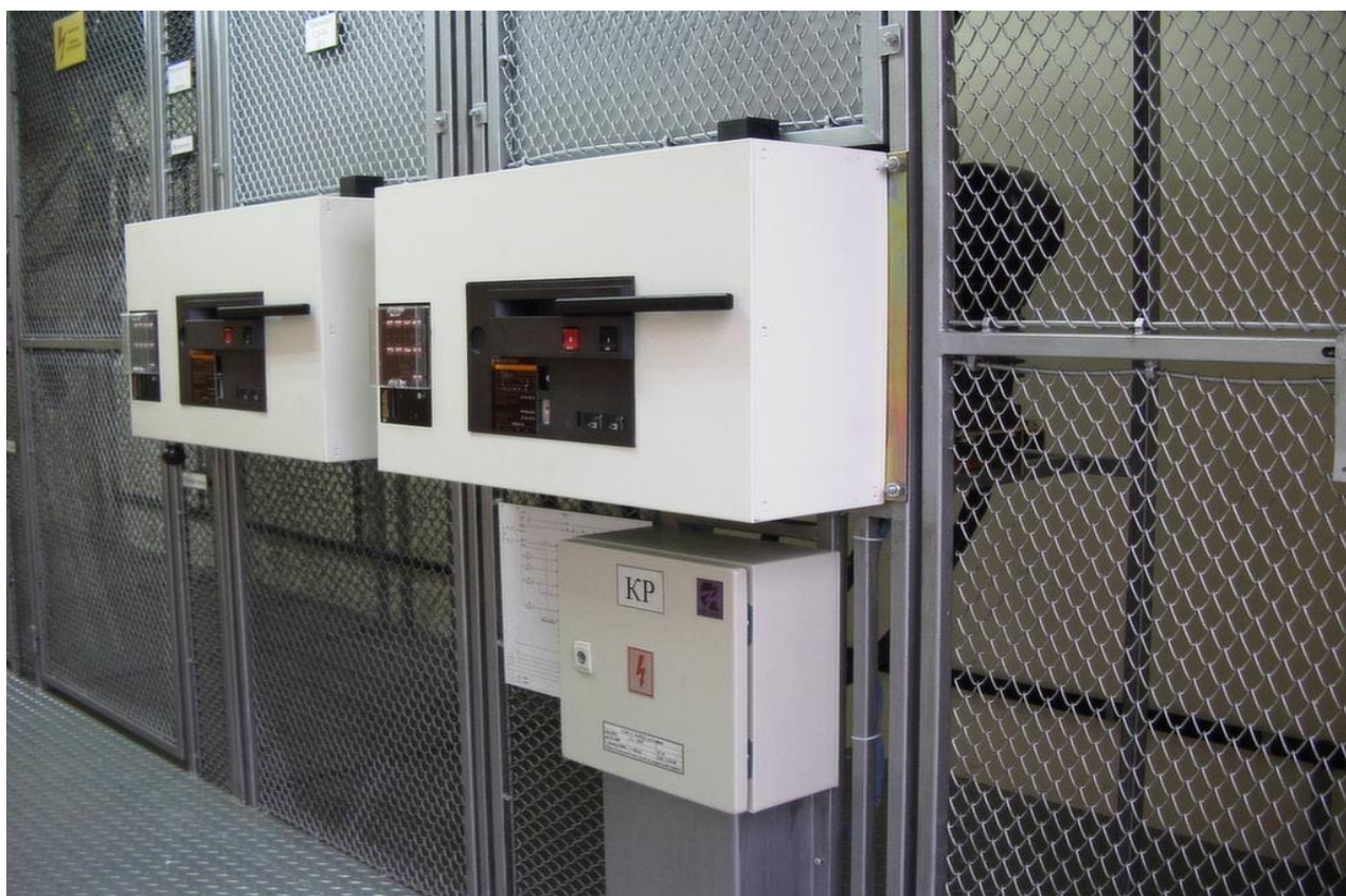
Фиг. 3. Електрическа уредба 6 kV
