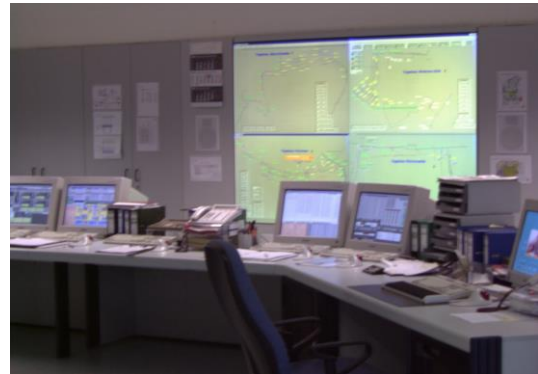
Abb. 8 Zentralleitstand der Entwässerung von VE-M
