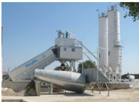
Сн. 1. Бетонов възел (мобилен)
