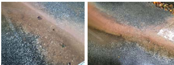
Фиг. 2. Бетонна повърхност в стадий на обща корозия.
