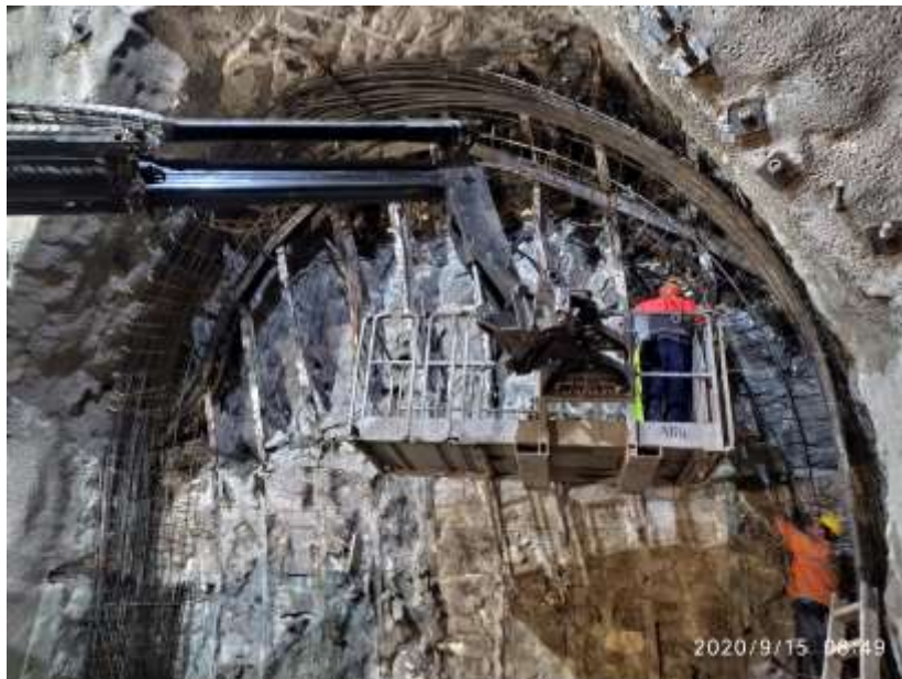
Фиг.4.31: Обезопасяване на навлизането на напречен тунел – изпълнен временен и постоянен портал в процес на изпълнение
