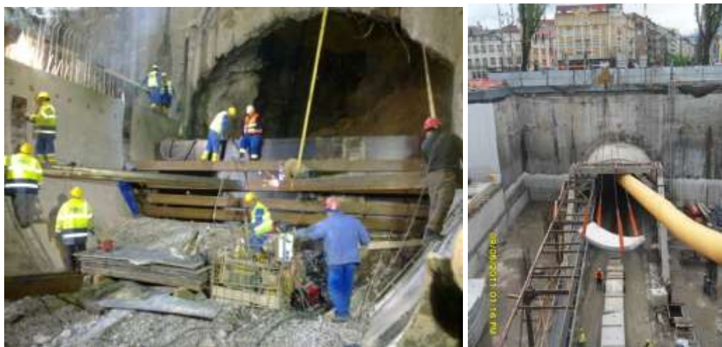
Фиг.4.57: Свличане под бул "Княгиня Мария Луиза" поради липса на входен тръбен портал за преминаване на ТВМ под Владайска река
