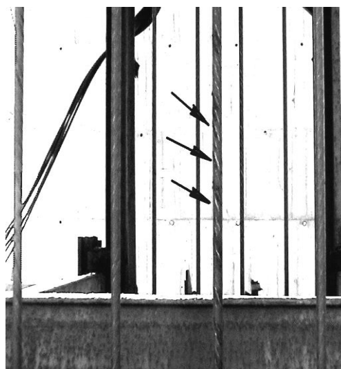
Фиг. 7. Дефектно подемно въже – едно от снопчетата е неравномерно натегнато и изпъкнало по винтова линия
