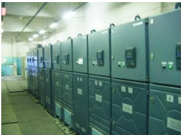
Фиг. 3. Външен вид на КРУ след реконструкция
