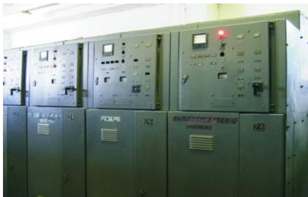
Фиг. 1. Външен вид на КРУ преди реконструкция
