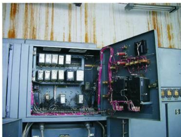
Фиг. 2. Релеен отсек на КРУ преди реконструкция
