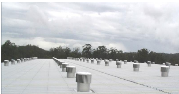
Фиг. 1. Използване на турбинните ветровентилатори за проветряване на производствени помещения
