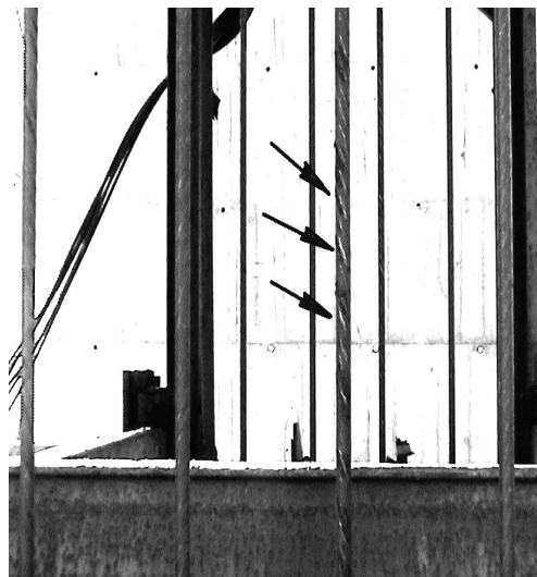
Фиг. 7. Дефектно подемно въже – едно от снопчетата е неравномерно натегнато и изпъкнало по винтова линия
