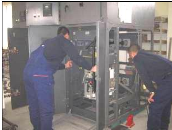
Фиг.3. – Стенд за наладка на КРУ в монтажния цех
