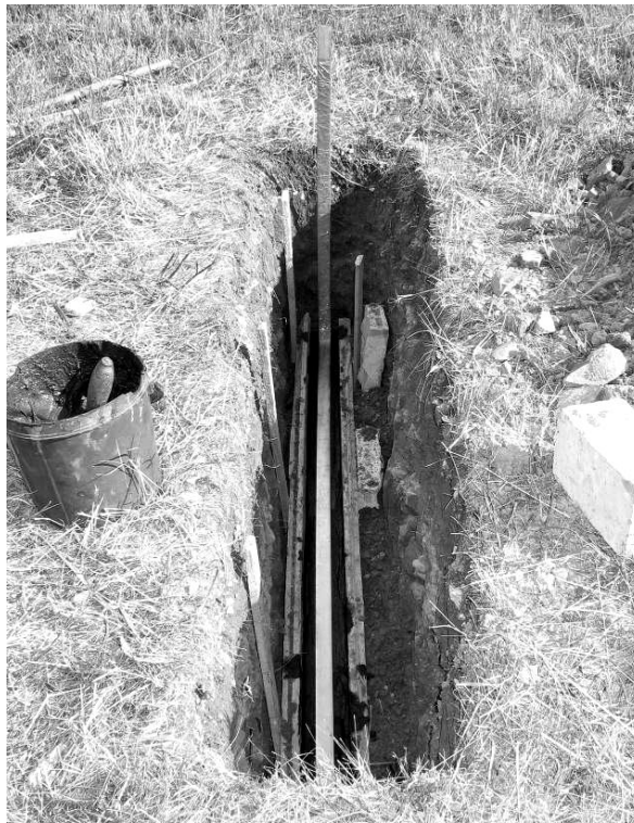
П. 1. Етап от полагането на хоризонтален лентов заземител с еднослойна проводима бетонна обmazка.
