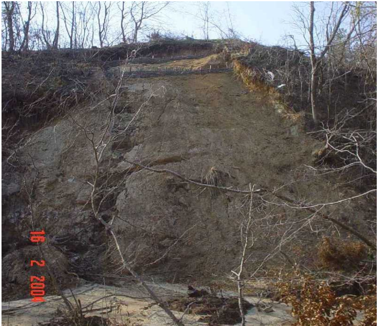
Сн. 2. Част от ската е загубил устойчивост и се е свлякъл на площ от 800-1000кв.м в зоната на подземно прокарания тръбопровод
